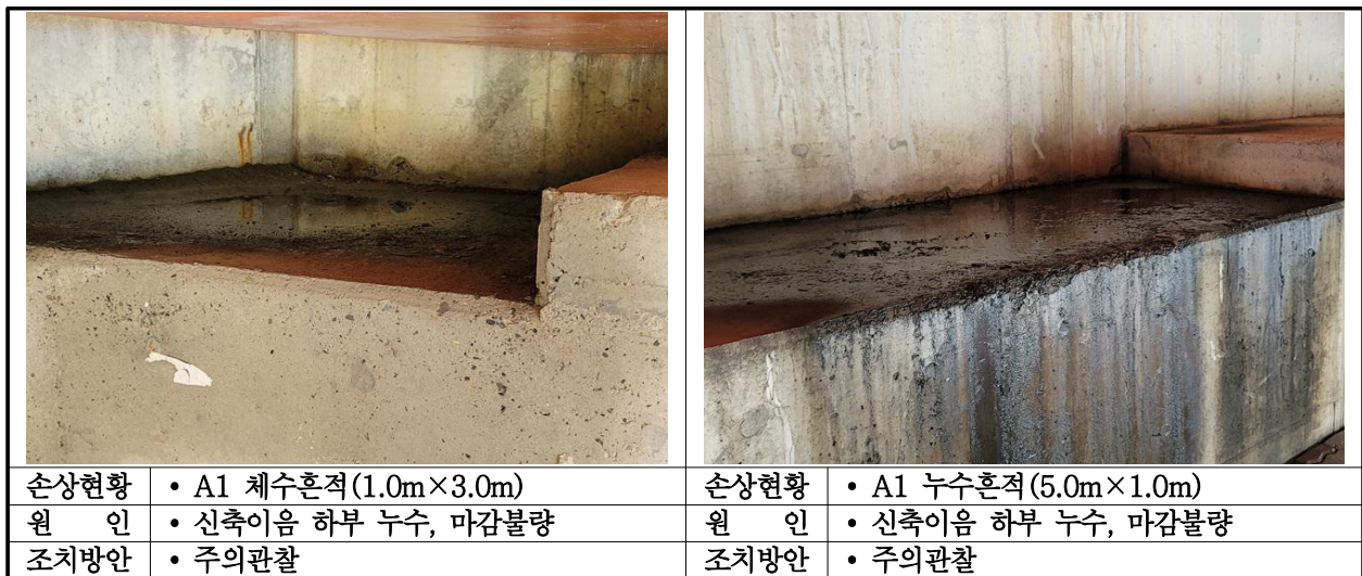
【사진 22.3.9】 교대 손상현황
